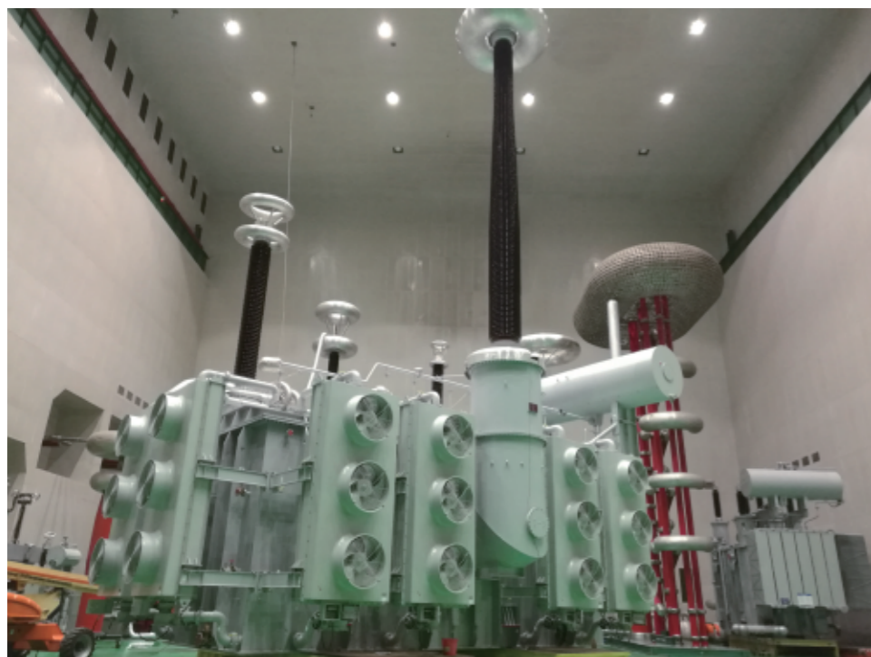
淮南 - 上海特高压工程苏州站 ODFPS-1000000/1000
