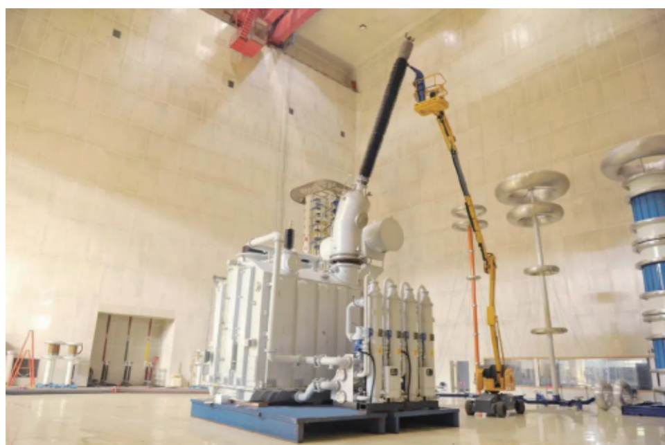
白鹤滩水电站 DSP-375000/500
